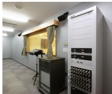
音響等操作室
