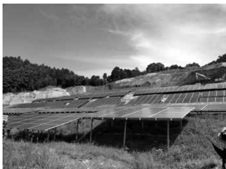
長井地区に設置された太陽光パネル
