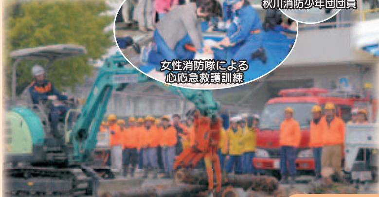
五日市警察署と西多摩緊急災害協力会による道路啓開訓練
