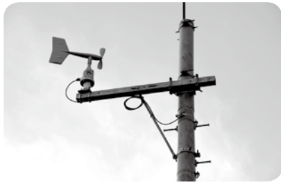
令和元年度に役場屋上に設置された風向風速計
