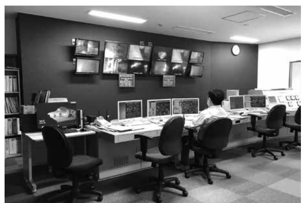
西秋川衛生組合中央制御室
