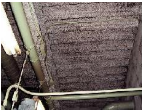
石綿含有吹付けロックウール
