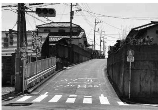
令和4年度舗装打ち換え工事が入札不調になったキグスリ坂
