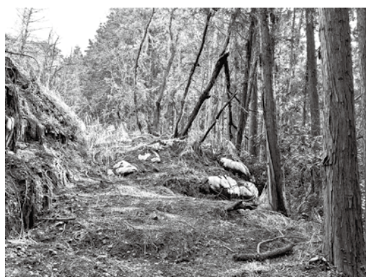
豪雨の影響により崩落した盛土現場(玉の内地区)
